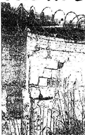
Estrutura está prejudicada.
