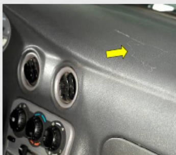
Riscos ou manchas pequenas nos painéis e consoles.
